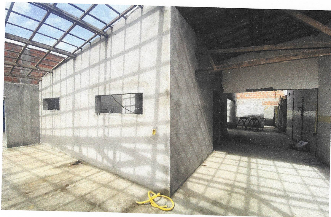
Foto 17 - -- MASSA ÚNICA, PARA RECEBIMENTO DE PINTURA OU CERÂMICA, ARGAMASSA INDUSTRIALIZADA, PREPARO MECÂNICO
