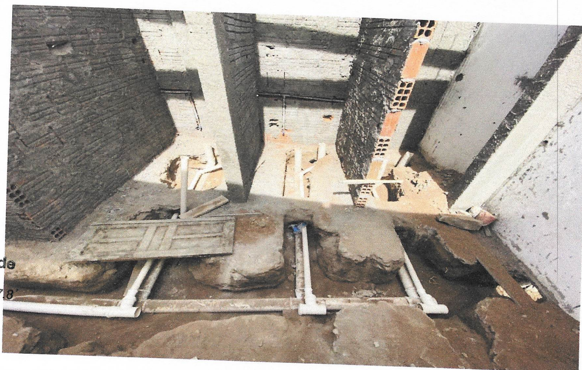
Foto 02 – Ponto de esgoto com tubo de PVC rígido soldável de Ø 100 mm.
